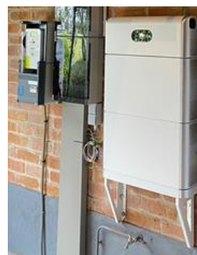
Huawei-omvormer en -thuisbatterijen (10 kWh) (MR Solar)
